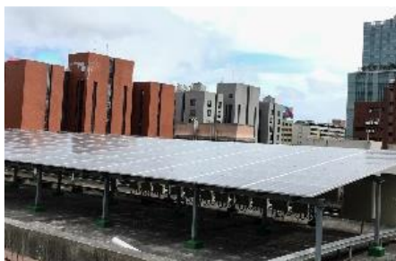
本校樓頂設置太陽能板實景圖
