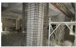
耐震補強工程
